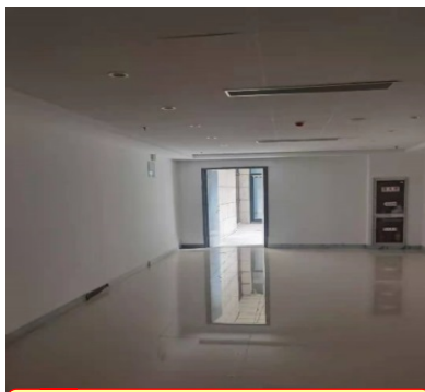
消防应急广播馈线电压未采用安全电压
