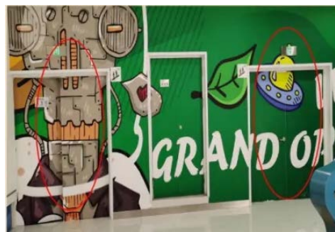
疏散通道、安全出口墙面采用整体广告，不便识别
