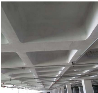
梁突出顶棚高度超过 600mm 时，未在被梁隔断的每个梁间区域内设置探测器
